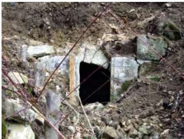
Vormauerung z.T. weg, Wurzelstoch sichtbar
